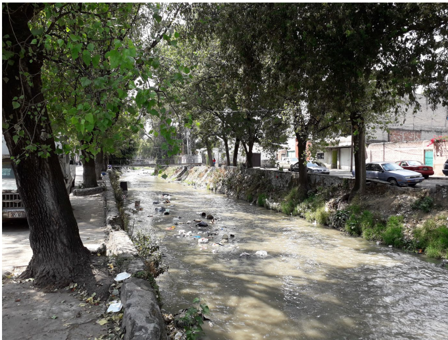
Figura 18. Traza discontinua y falta de banquetas
